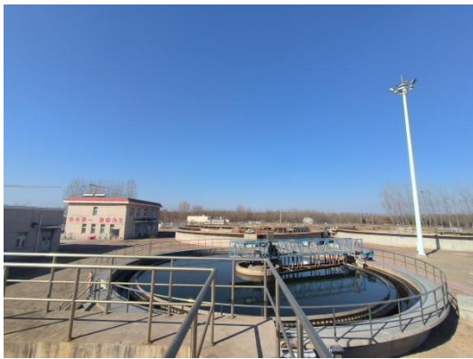
图 京平公司污水处理厂终沉池
